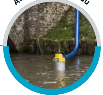
Alimentation en eau
