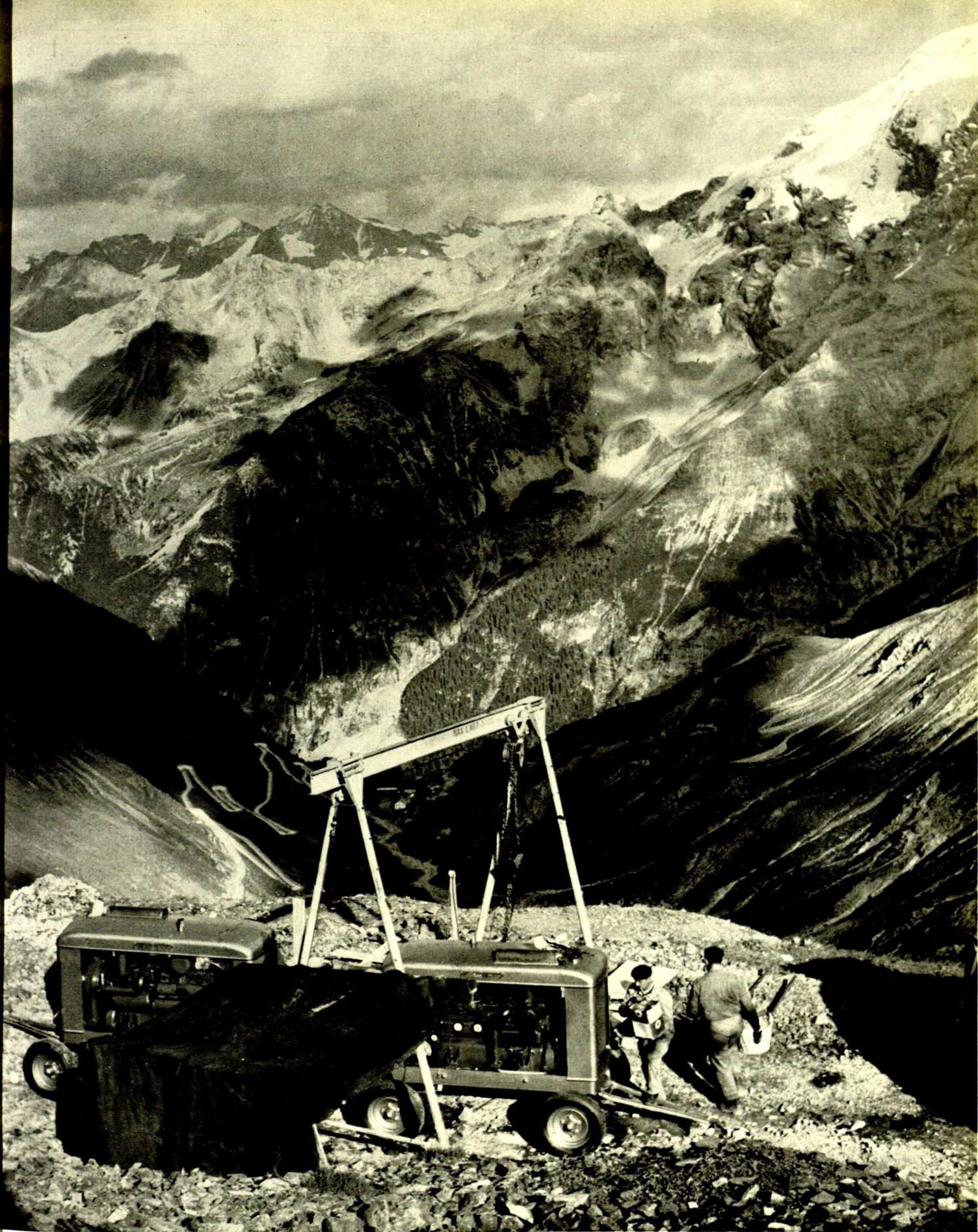
Transportabla Atlas Copco-kompressorer i arbete på 2 800 meters höjd vid Stelviopasset i italienska alperna.
