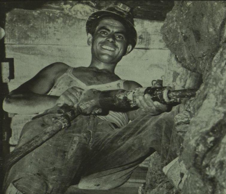
Bilden ovan visar en av Atlas Copcos bilningshammare vid ett tunnelbygge för Autostrada del Sole i Italien.
