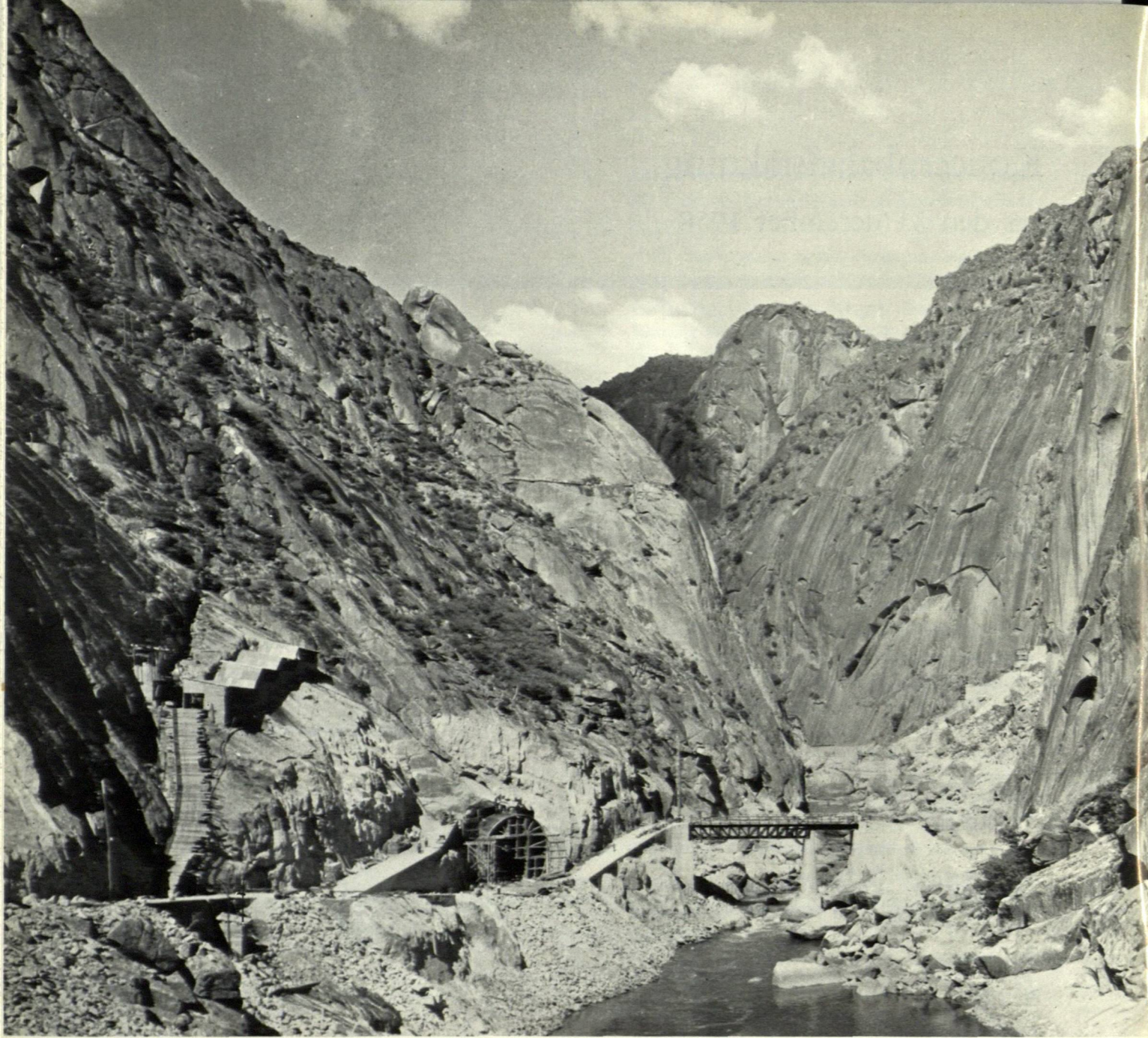
Bilden ovan är hämtad från Salto de Aldeadávila i Spanien, där Europas största vattenkraftverk är under anläggning. Tunneldrivningen utföres med Atlas Copcos bergbormaskiner och Sandvik Coromant borrstål.
