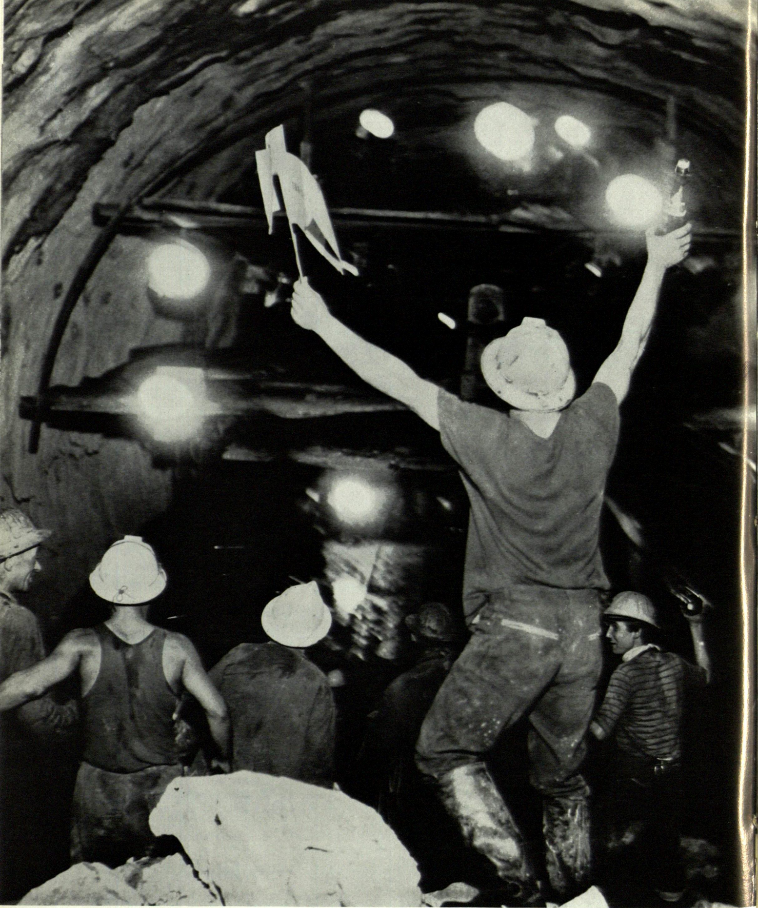
Sista genomslaget 2.700 meter under Mont Blancs snötäckt hjässa. Den 14 augusti 1962 sköt de franska tunnelarbetarna sista salvan som tog dem igenom till de väntande italienarna. Ögonblicket var kulmen av nära fyra års samarbete mellan den italienska entreprenören, Società Italiana per Condotte d'Acqua, och Atlas Copco.
