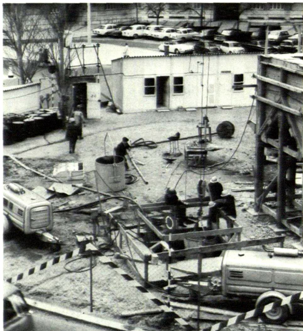
Fyra VT-kompressorer och ett stort antal Tex-spett används vid ett kilometerlångt tunnelbygge i Lissabon.
