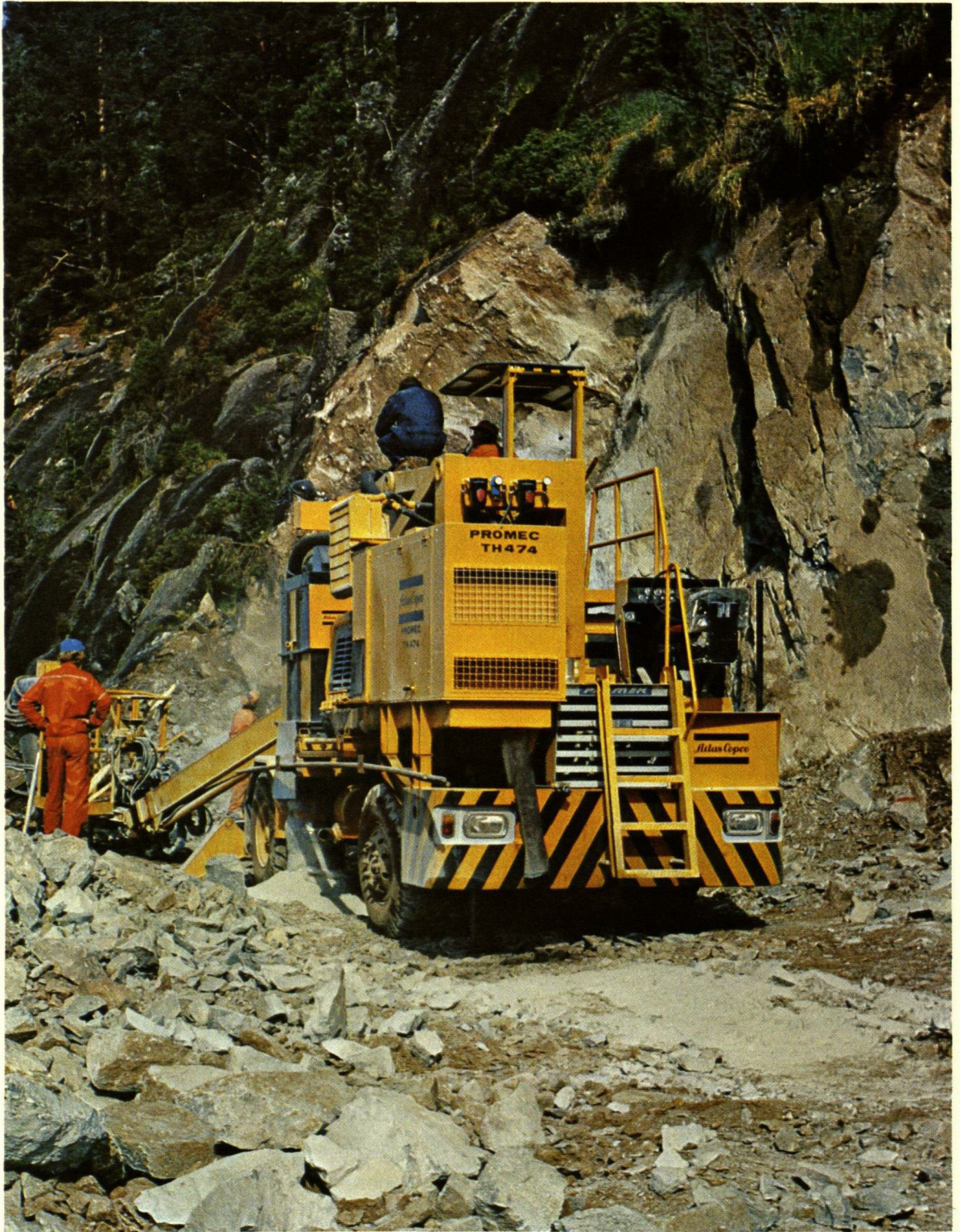
Atlas Copco har i samarbete med det norska vägverket specialkonstruerat ett hydrauliskt bergborraggregat för vägbyggnad i kuperad terräng. Intresset för aggregatet är stort bland såväl vägverkets folk som privata entreprenörer.
